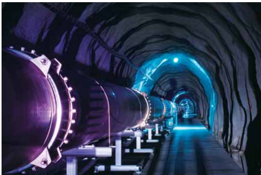
まっすぐ3km続くKAGRAのトンネルと真空ダクト
